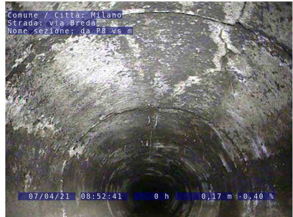
2, 00:00:21, 0.17m Formazione di crepe longitudinali, 10 mm largo/a, a ore 1
