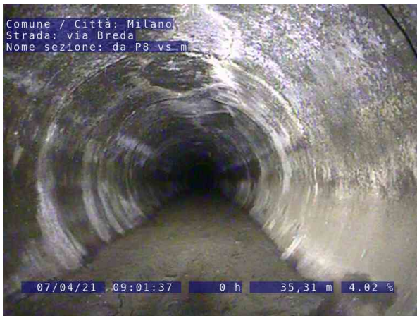
15, 00:06:27, 35.31m Rottura del tubo senza pezzi mancanti da ore 11 a ore 1
