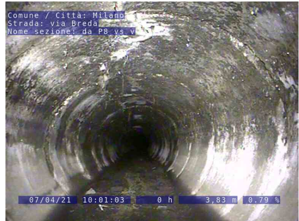
2, 00:00:29, 3.83m Rottura del tubo senza pezzi mancanti da ore 12 a ore 12
