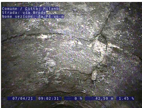
17, 00:07:07, 42.50m Rottura del tubo senza pezzi mancanti, a ore 1
