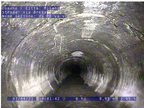
3, 00:00:56, 8.95m Rottura del tubo senza pezzi mancanti da ore 9 a ore 12
