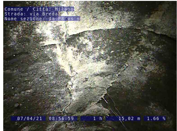
8, 00:03:12, 15.02m Rottura del tubo senza pezzi mancanti da ore 1 a ore 2
