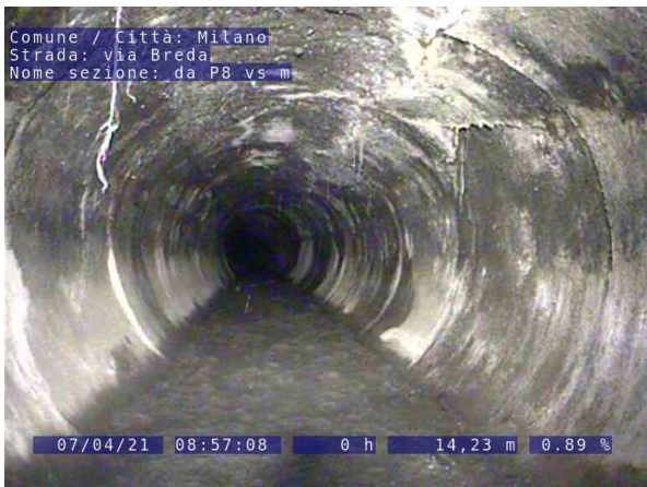
9, 00:03:12, 15.02m Rottura del tubo senza pezzi mancanti da ore 1 a ore 2
