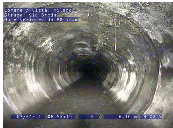
6, 00:01:59, 6.16m Formazione di crepe longitudinali, 20mm largo/a a ore 1
