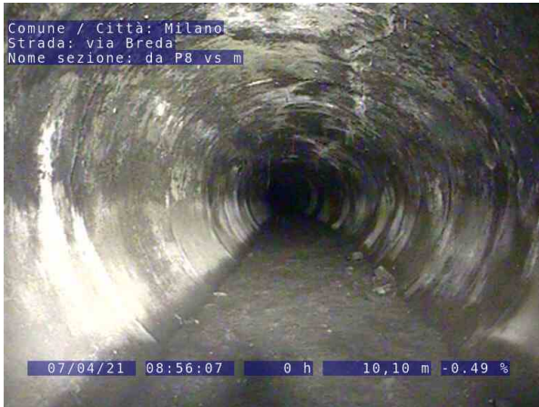
7, 00:02:36, 10.10m Formazione di crepe longitudinali, 20mm largo/a a ore 1
