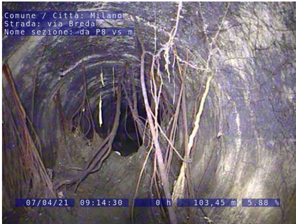
37, 00:16:08, 104.14m Apparato radicale complesso, 30% Diminuzione di diametro da ore 9 a ore 3
