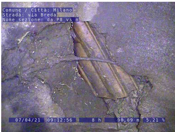
33, 00:14:53, 90.09m Rottura del tubo con parti mancanti, a ore 8
