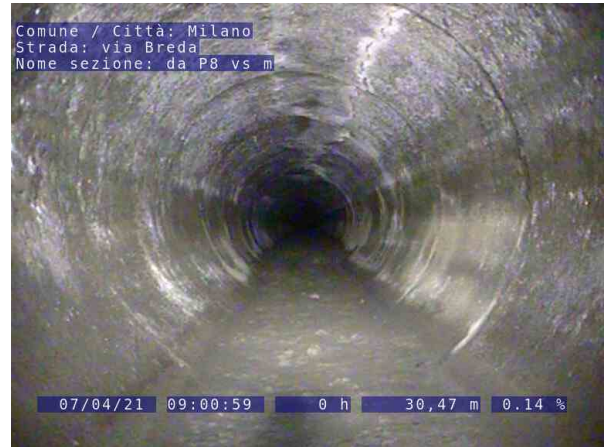
14, 00:06:04, 30.47m Formazione di crepe longitudinali, 10 mm largo/a, a ore 1
