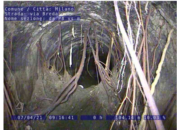
38, 00:16:08, 104.14m Apparato radicale complesso, 30% Diminuzione di diametro da ore 9 a ore 3
