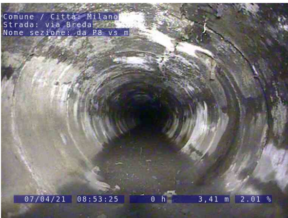
3, 00:00:52, 3.41m Rottura del tubo senza pezzi mancanti da ore 12 a ore 12
